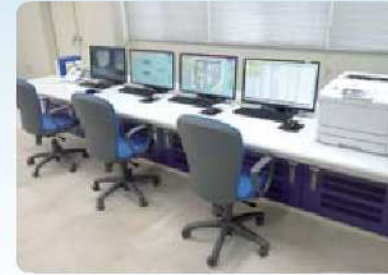
中央管理設備 (管理棟内) 浄水場の施設の稼働状況を、この中央管理室で管理・操作します。
