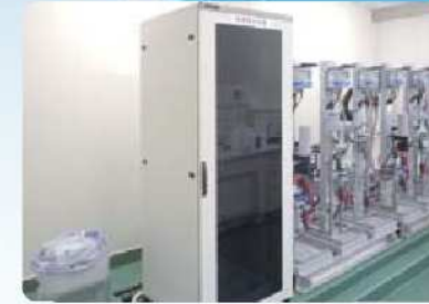
水質計器設備 (管理棟内) 着水井の水(原水)と、沈殿池で水中の濁りを取り除いた水(配水)の水質を計っています。
