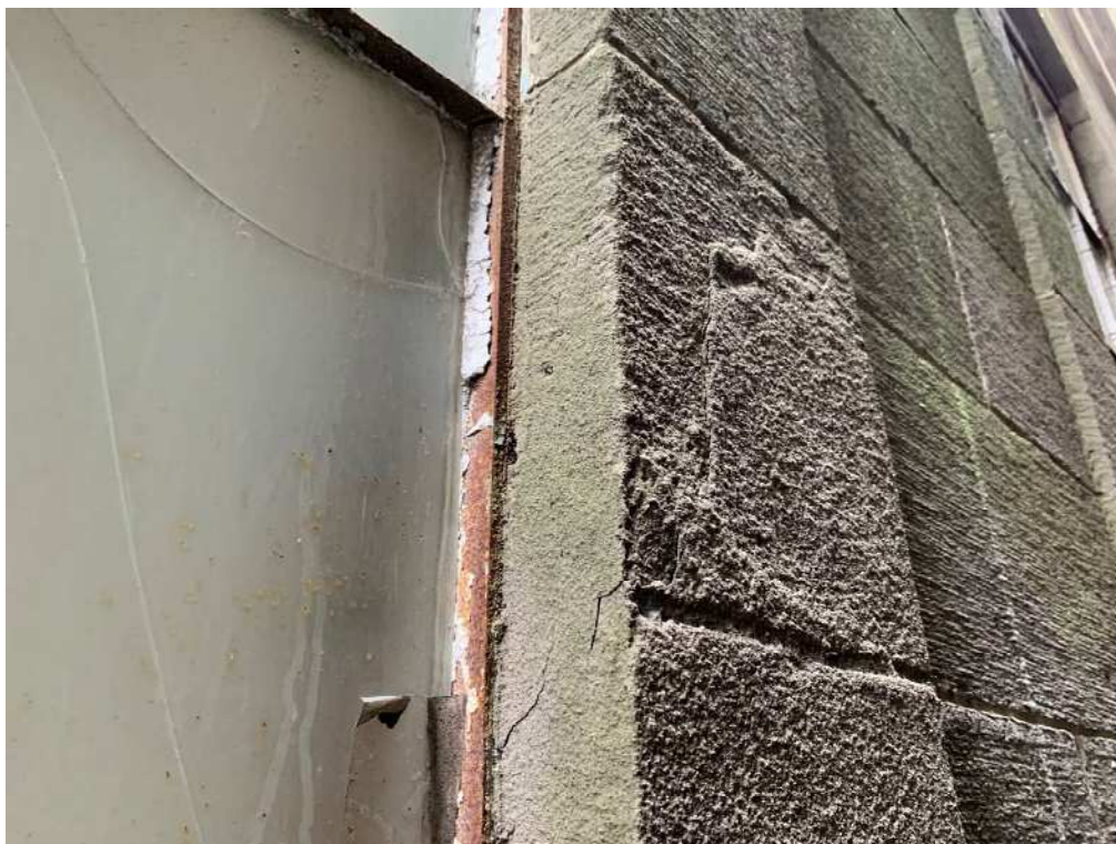
写真 1-3a 外壁劣化状況
