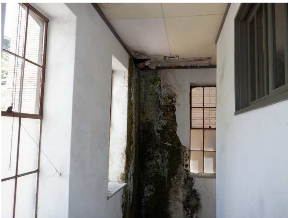
写真 1-3b 内部雨水侵入状況
