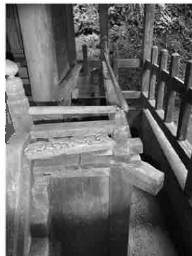
写真13 芻高欄と脇障子の損傷
