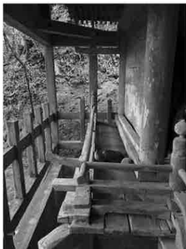
写真12 切目縁板と脇障子の損傷
