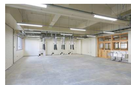
配線・配管を見て学べる 溶接実習室
