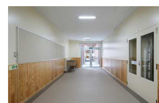
内部構造が見える分電盤 が設置された廊下
