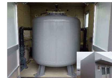
機械室 RC造 砂式ろ過装置
