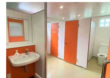
明るく清潔な 洋式・乾式トイレ
