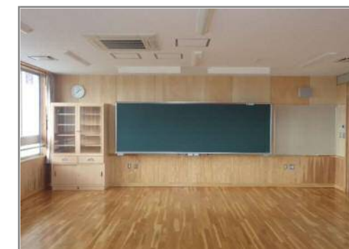
空調を設置した 快適な教室
