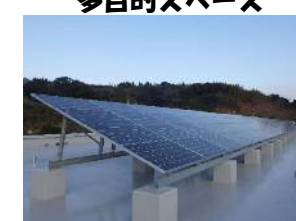
太陽光発電設備
