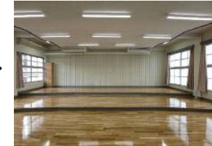
音楽室（改造後） 空調を設置しました！
