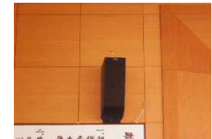
スピーカーの落下防止対策 (ワイヤーを設置)
