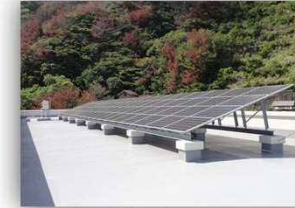
太陽光発電システム （A棟屋上）
