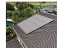
太陽光発電パネル （10kw）
