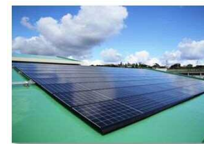
太陽光発電システム
