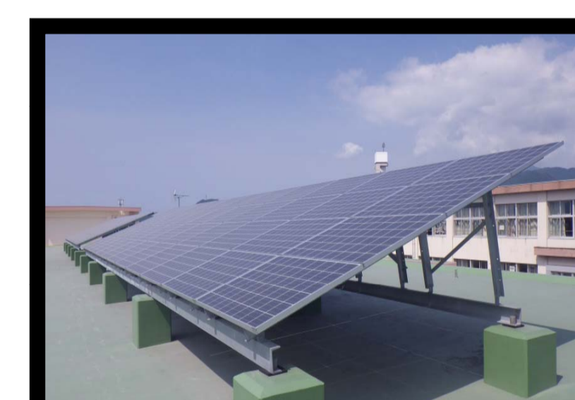
太陽光発電システム
