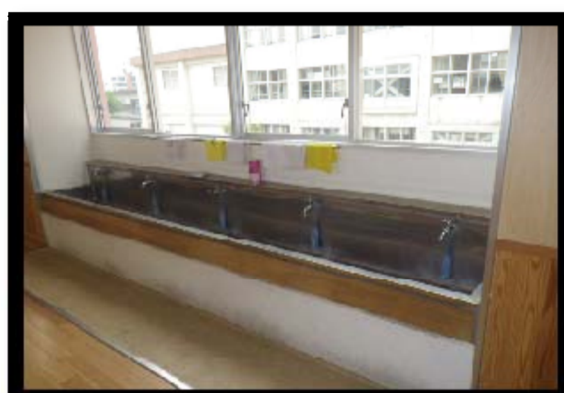
各教室の廊下に備え付けら れた水道
