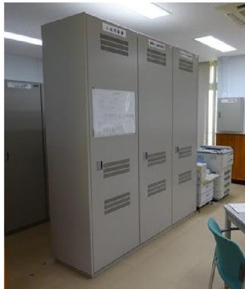
ダム管理所 操作室
