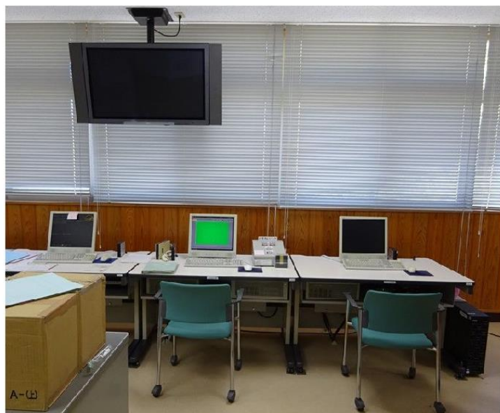
ダム管理所 操作室
