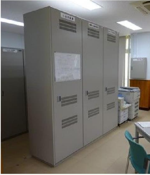
ダム管理所 操作室
