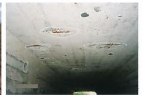
樋門・樋管(鉄筋の露出・腐食)
