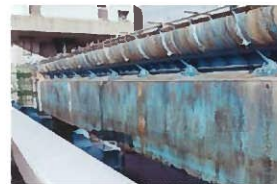
水門(ゲート塗装の劣化)
