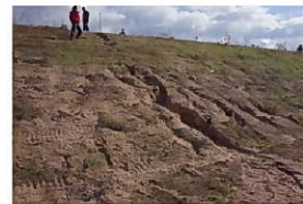
堤防(法面の浸食)
