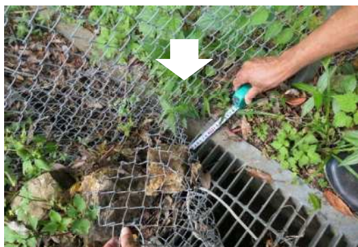
側溝沿いに生じた隙間
