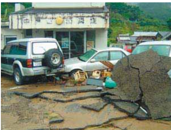
道路のアスファルトがめくれる程, 強い濁流が集落を襲った (龍郷町 戸口集落)
