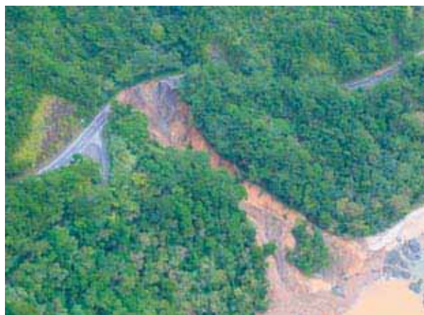
崩落により道路が欠落し, 通行止めとなった (奄美市 笠利町 佐仁赤木名線)
