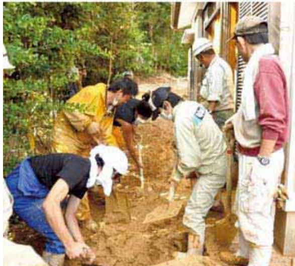
復旧作業に多くのボランティアが協力 (大和村)
