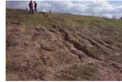
堤防(法面の浸食)
