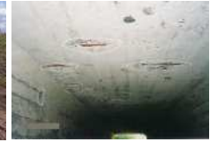
樋門・樋管(鉄筋の露出・腐食)
