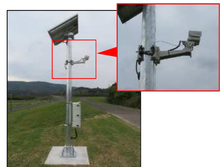
簡易型河川監視カメラ
