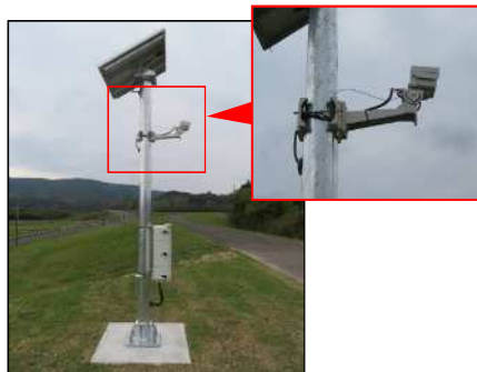
簡易型河川監視カメラ
