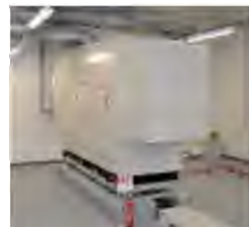
非常用発電設備のイメージ
