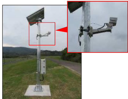
簡易型河川監視カメラ
