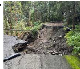
被災状況（道路流出）
