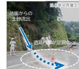
被災状況（道路内部の空洞化）
