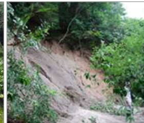
被災状況（法面崩壊）
