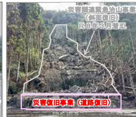
被災状況（法面崩壊）
