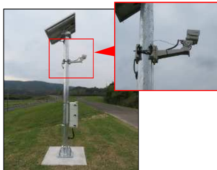
簡易型河川監視カメラ
