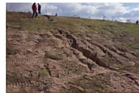
堤防(法面の浸食)
