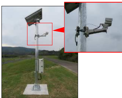
簡易型河川監視カメラ
