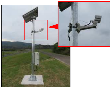
簡易型河川監視カメラ
