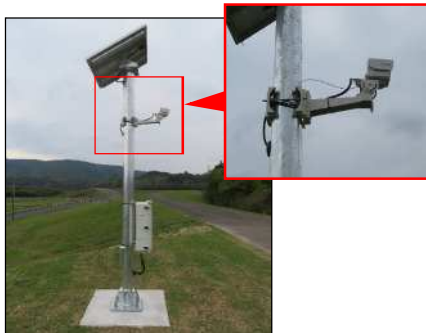
簡易型河川監視カメラ
