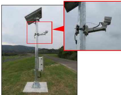
簡易型河川監視カメラ
