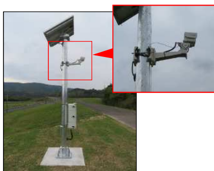
簡易型河川監視カメラ
