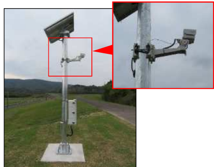
簡易型河川監視カメラ
