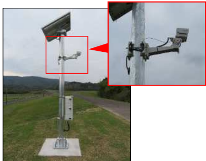
簡易型河川監視カメラ
