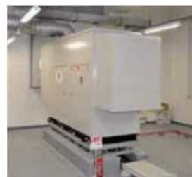
非常用発電設備のイメージ
