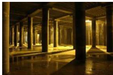
大規模地下貯留施設(下水道)
