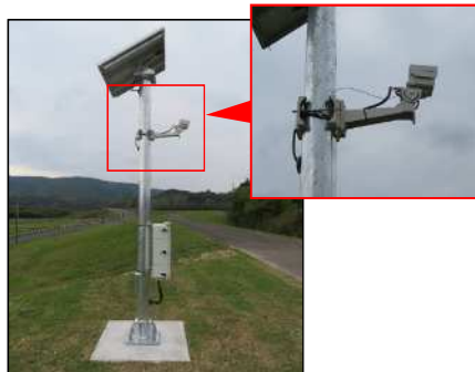
簡易型河川監視カメラ
