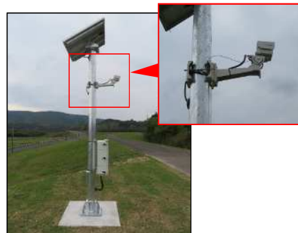
簡易型河川監視カメラ
