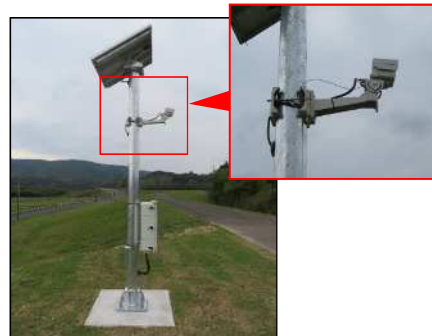
簡易型河川監視カメラ
