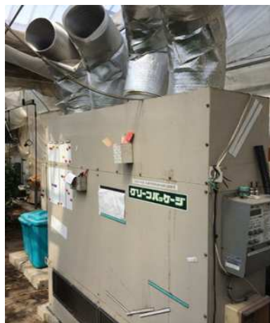
図2 ヒートポンプ
