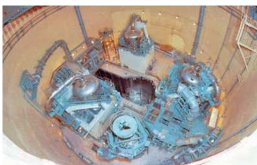
原子炉格納容器内部
