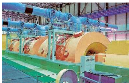
タービン・発電機
