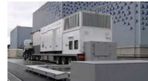
②大容量空冷式発電機
