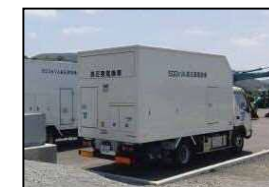
〔高圧発電機車：4台〕
