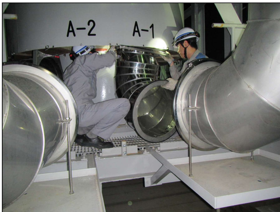
非常用ディーゼル発電機への フィルタコンテナ接続
