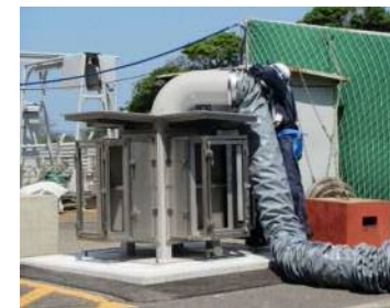
フィルタコンテナユニットへのダクト接続
