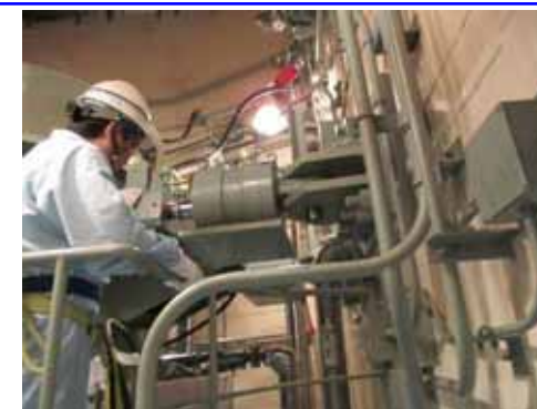
1次冷却材ポンプ支持構造物 (オイルスナバ)
