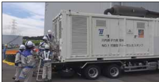
可搬型ディーゼル注入ポンプの設置
