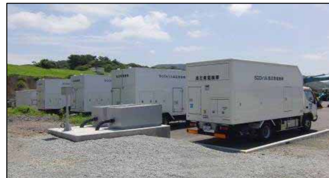
高圧発電機車
