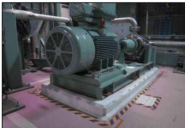
(A) 常設電動注入ポンプ
