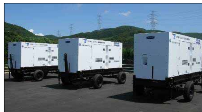
直流電源用発電機
