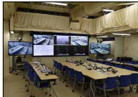
代替緊急時対策所（室内）
