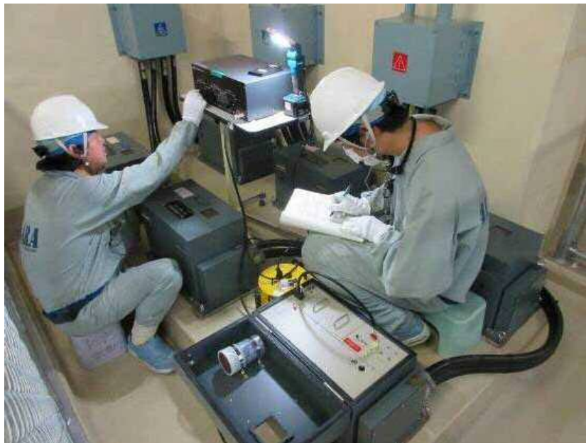
原子炉停止用地震計点検
