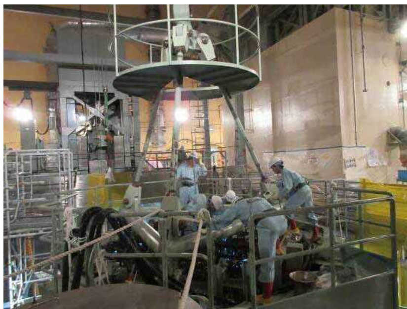
制御棒駆動装置、制御棒位置指示装置 ケーブルコネクタ部点検
