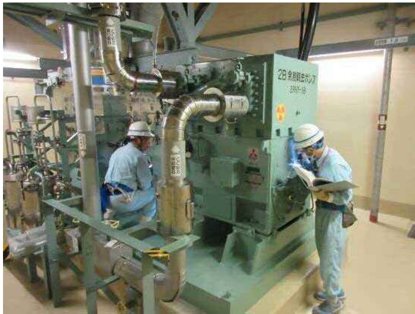
余熱除去ポンプ作動試験
