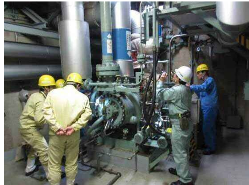
タービン動補助給水ポンプ作動試験
