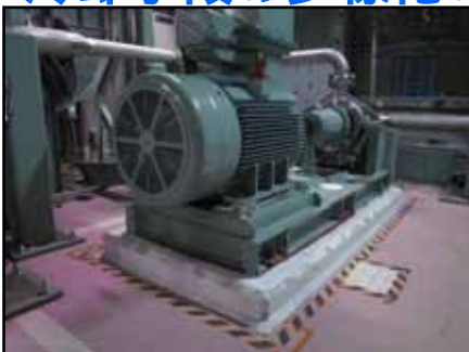
常設電動注入ポンプ
