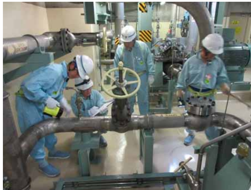
支持装置点検
