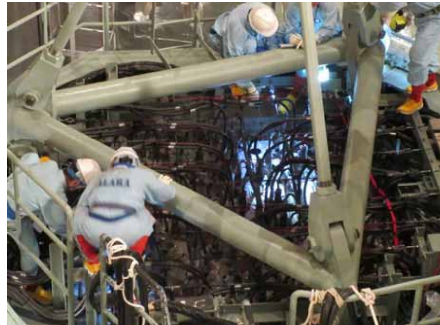
制御棒駆動装置、制御棒位置支持装置 ケーブルコネクタ部点検
