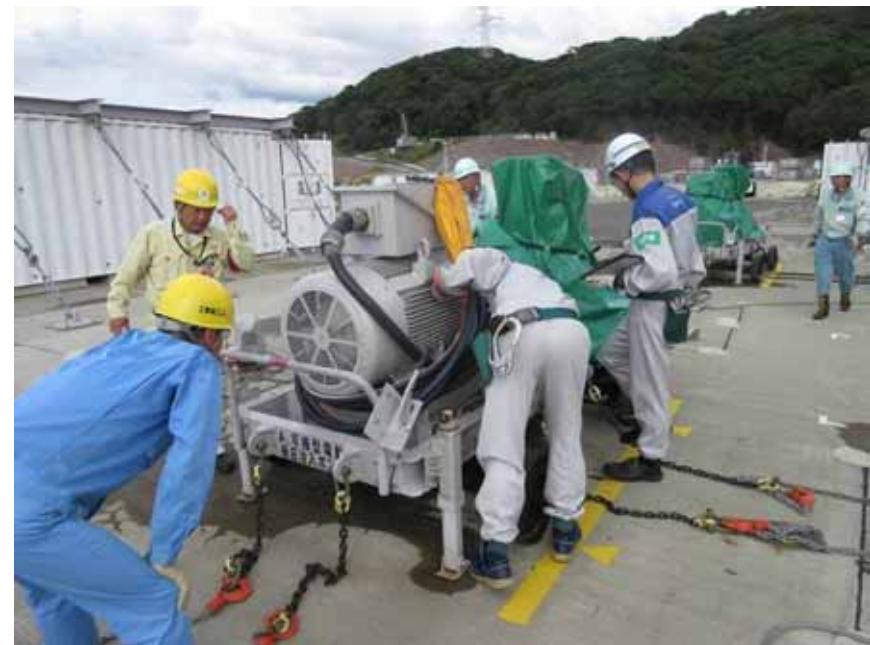
バックアップ設備点検(可搬型電動低圧注入ポンプ)
