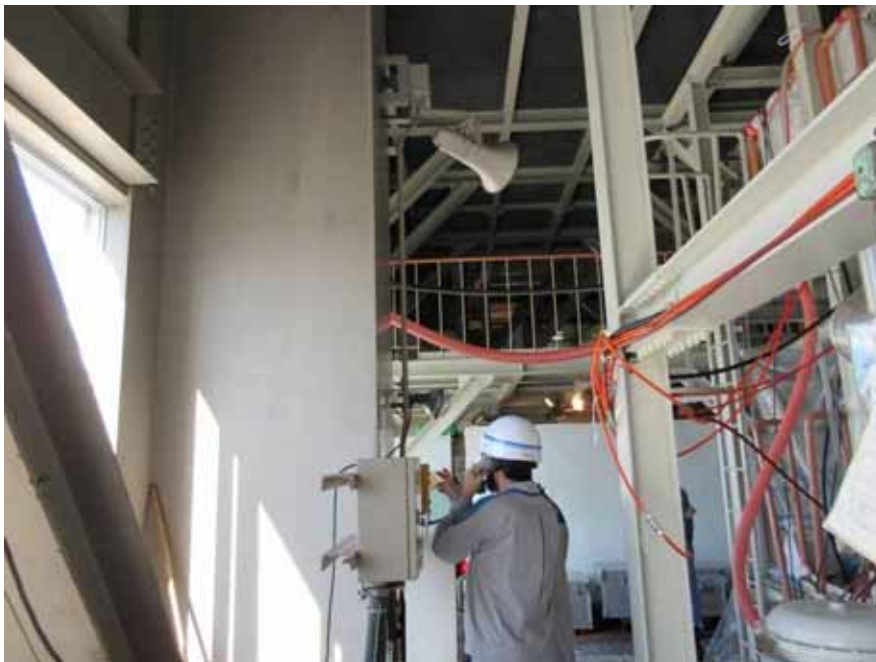
通信機器点検(所内放送・通話装置)
