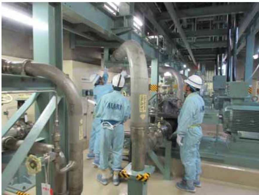
支持装置点検
