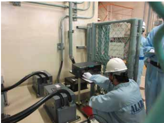
原子炉停止用地震計点検
