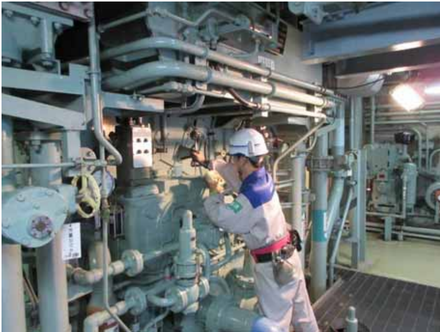
非常用ディーゼル発電機作動試験
