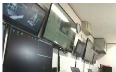
コンテナハウス内
